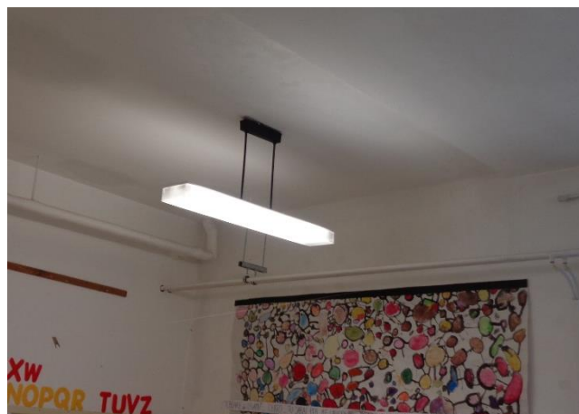
Figura 4.16 - Particolare dei corpi illuminanti ubicati nelle aule
