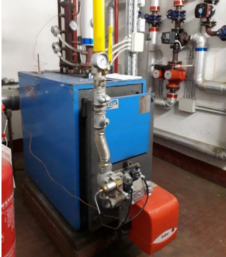
Figura 4.11 - Particolare generatore di calore
