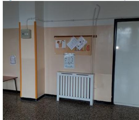
Figura 4.6 – Particolare radiatore su parete interna
