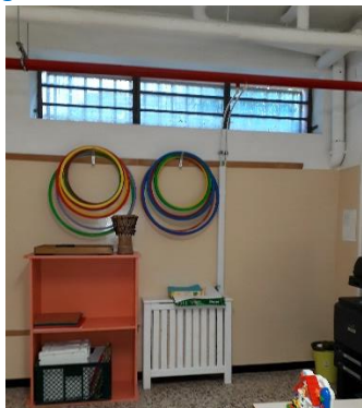
Figura 4.5 - Particolare radiatori su parete esterna
